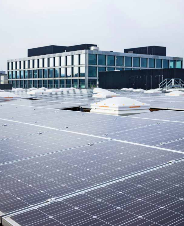
Eniwa baut die Produktion von Solarenergie aus. Im Bild die Photovoltaikanlage auf dem Dach des Neubaus in Buchs mit einer Jahresproduktion von 205000 Kilowattstunden (kWh), einer Leistung von 235 Kilowatt Peak und einem Speicher von 100 kWh.
