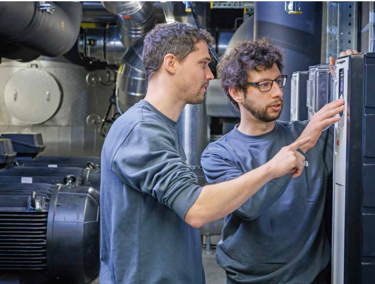
Haben den Betrieb der Energiezentrale Torfeld im Griff: Roland Lüthi (links) und Teamleiter Benjamin Gysi.
