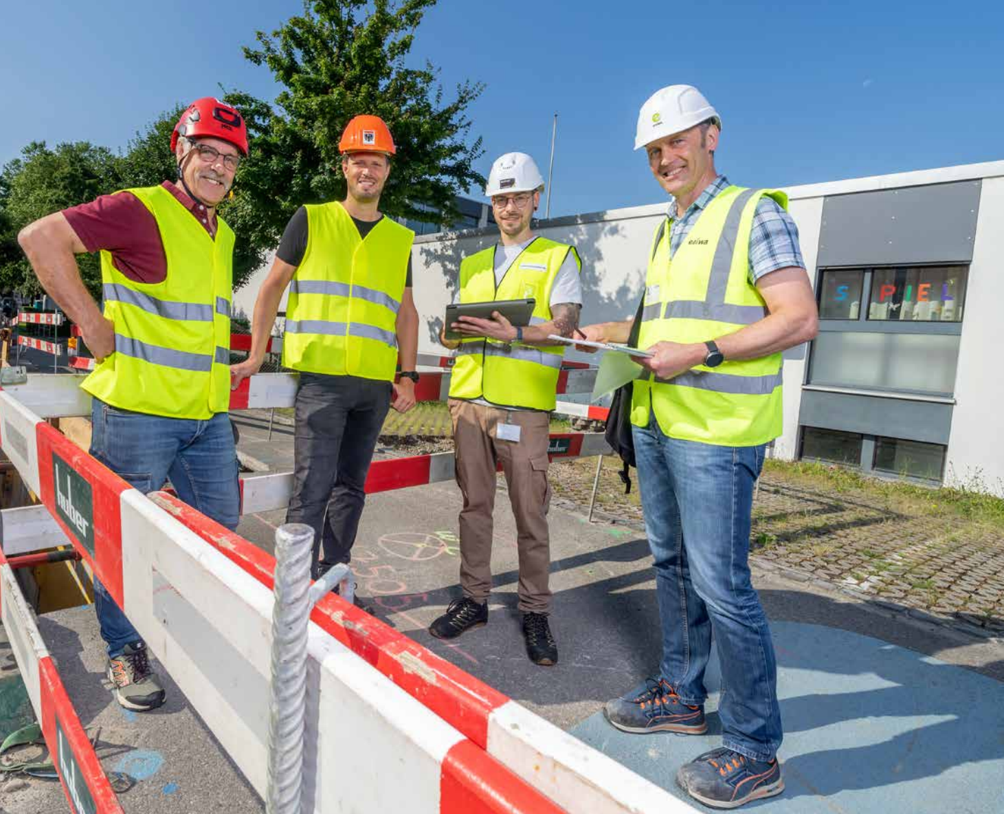
Stadt Aarau, Schule, Bodmer Bauingenieure AG und Eniwa arbeiteten eng zusammen: Vor Ort machten sich ein Bild (v.l.): Daniel Kyburz (Standortleiter Schachen), Carsten Diel (Stadtbauamt), David Marfil (Bodmer Bauingenieure) und Bernhard Marti (Eniwa).
